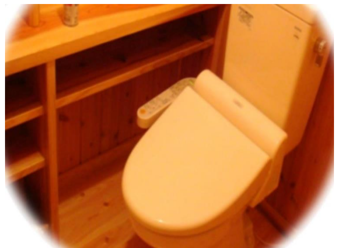
トイレ：2 ヶ所あり。どちらも温水洗浄便座が取り付けであります。
